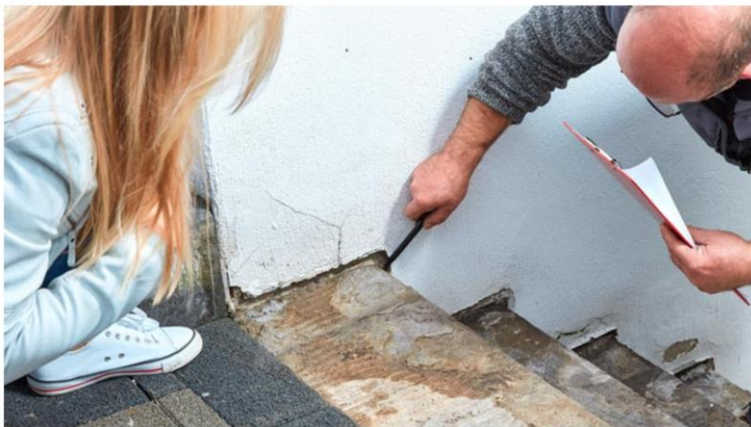
Auch als Laie können Eigentümerinnen und Eigentümer eine visuelle Kontrolle der Bauteile vornehmen, um allfällige Mängel am Gebäude zu erkennen. Für die Kontrolle und den Unterhalt komplexer Bauteile empfiehlt es sich jedoch, eine Fachperson beizuziehen. BILD: KARIN & UWE ANNAS - STOCKADOBESTOCK
