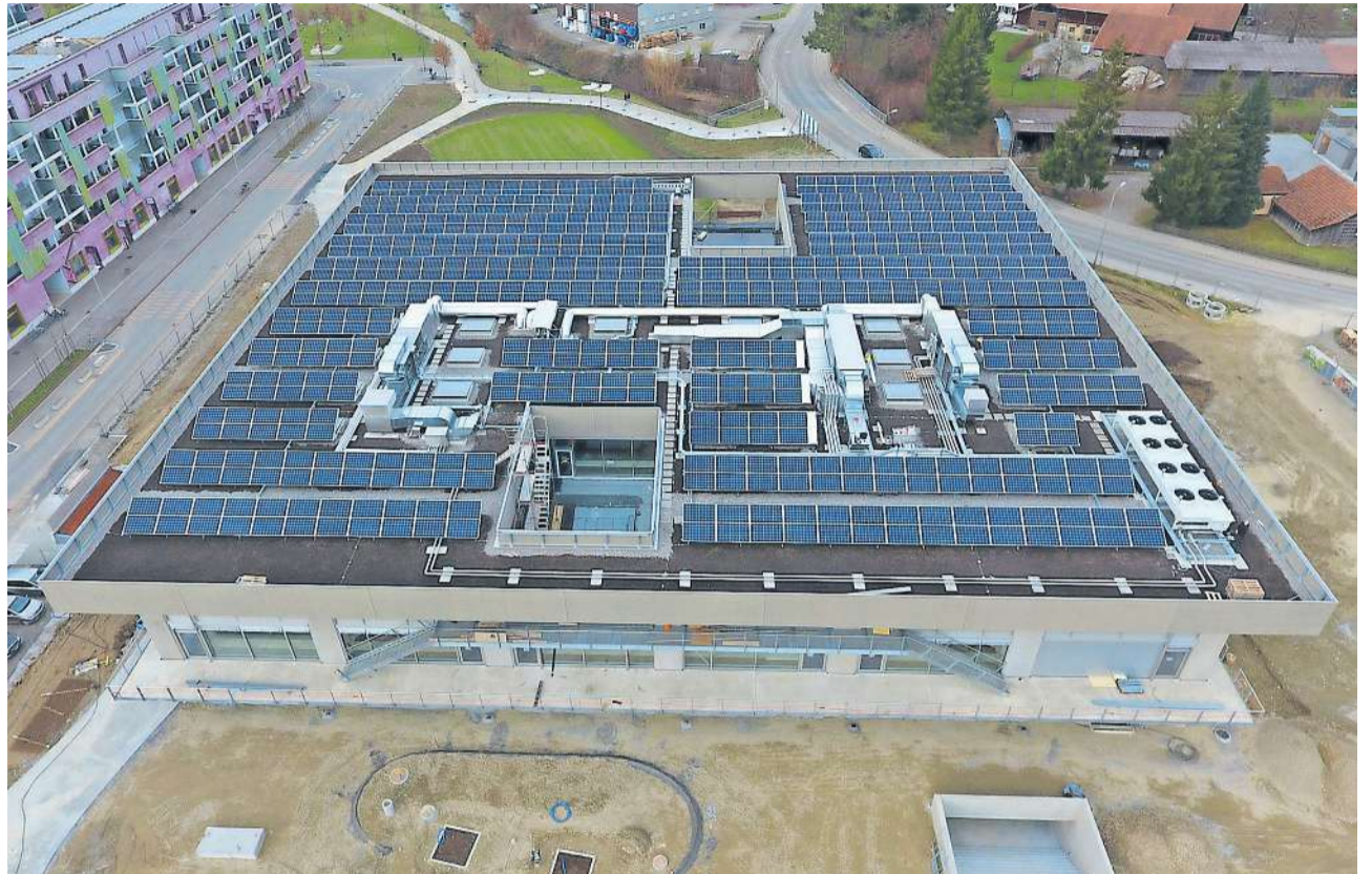
Fotovoltaik-Anlage auf dem Dach des Schulhauses Winterthur Hegi.
