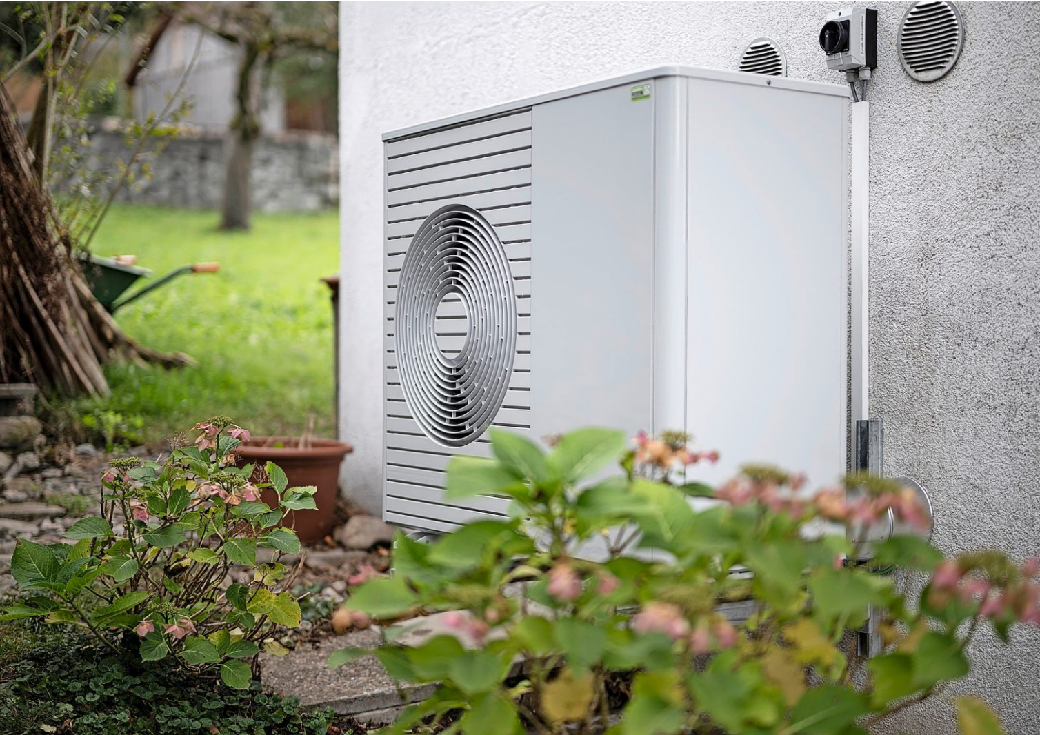
Aussen installierte Luft-Wasser-Wärmepumpen bedürfen in der Regel einer Bewilligung.
